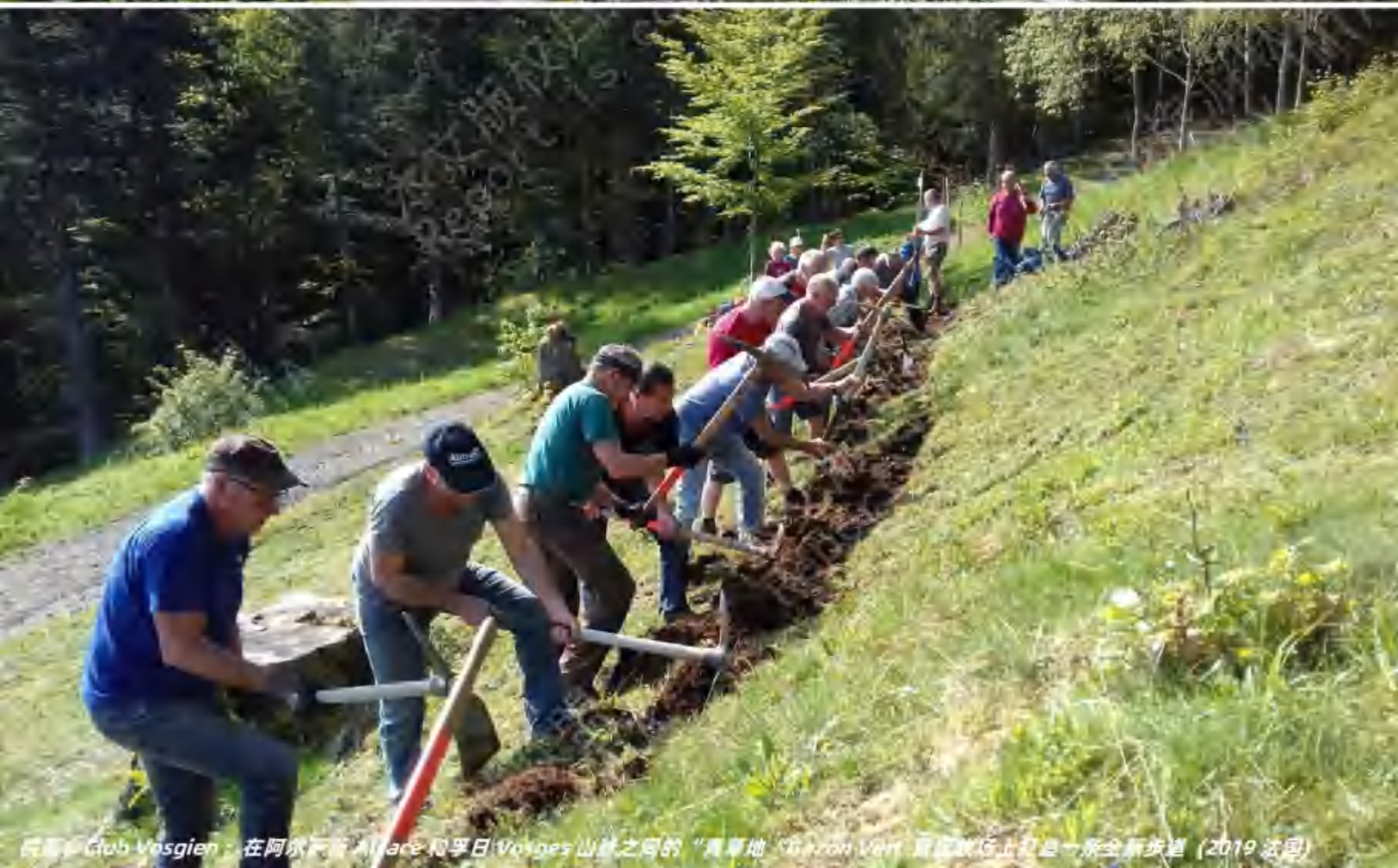
拍摄©高宁 Serge Koenig :成都平乐一条由阿尔卑斯-四川合作社主导的新建步道施工(中国)
